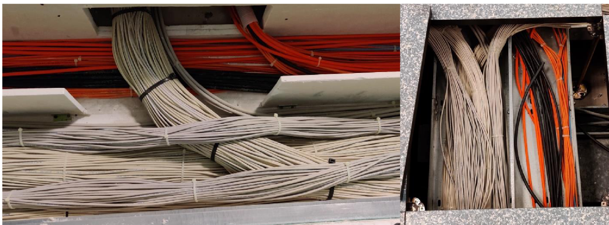
Obrázek 9 - Aktuální stav kabeláže vlevo chodba, vpravo sál (Vlastní fotografie)
