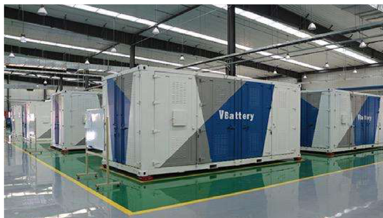
Obrázek 18 Průtočné baterie (Wagner, 2018)
