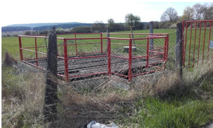
Obrázek č. 3 – Štěrbínová nádrž ŠN7 v obci Pšov (Foto: VODAKVA 04/2017).
