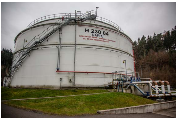
Obrázek 9: Nádrž ČEPRO pro skladování nafty
