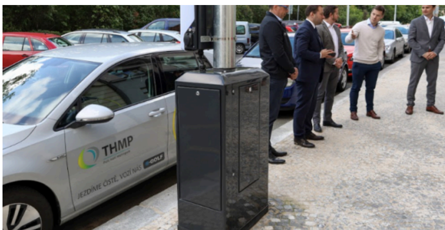
Obrázek č. 7: EV ready lampa na Vinohradech
