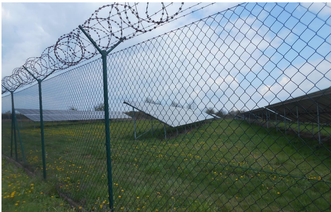
Obrázek 30: Detail FVE v obci Polom (špatné umístění)
