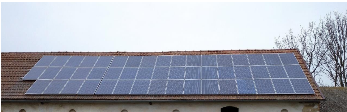
Obrázek 6-2 Pohled na fotovoltaické panely
