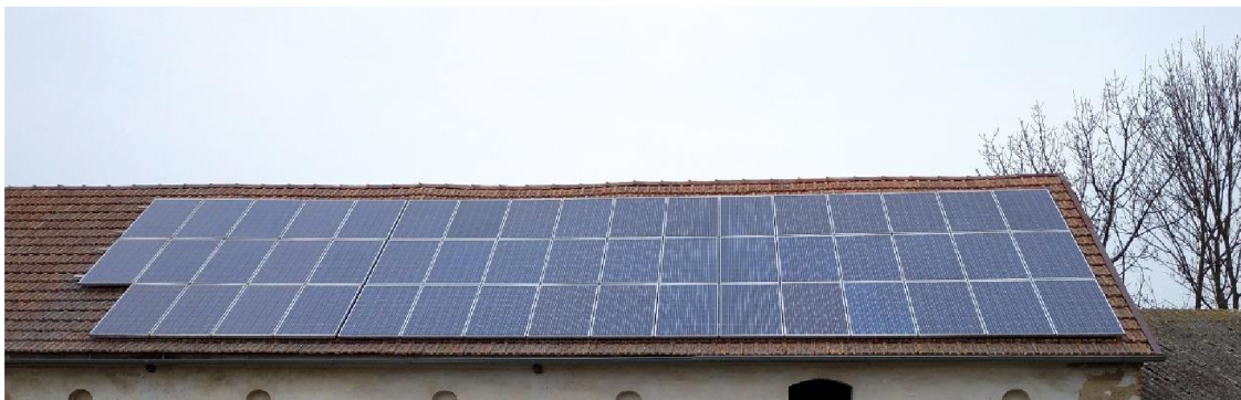
Obrázek 6-2 Pohled na fotovoltaické panely
