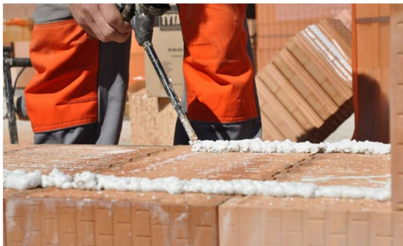
Obrázek 12: Novodobá ukázka spojování cihel pomocí polyuretanové pěny [24].
