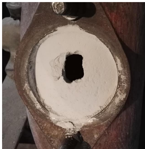
Obrázek 20: Proražená poduška v otvoru kulového mlýnu
