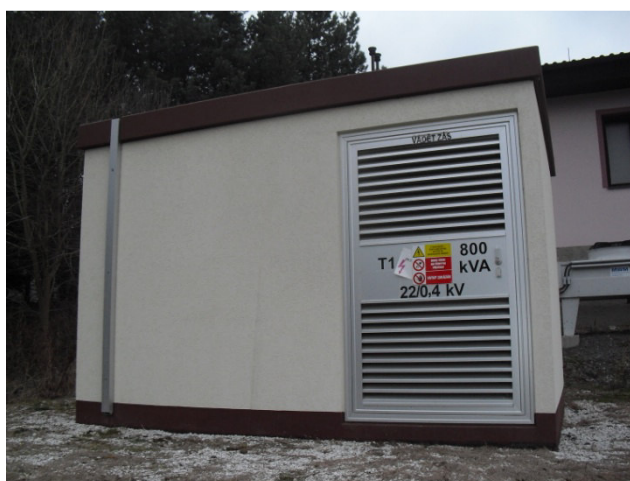
Obrázek č. 15 – Trafostanice (Zdroj: autor)
