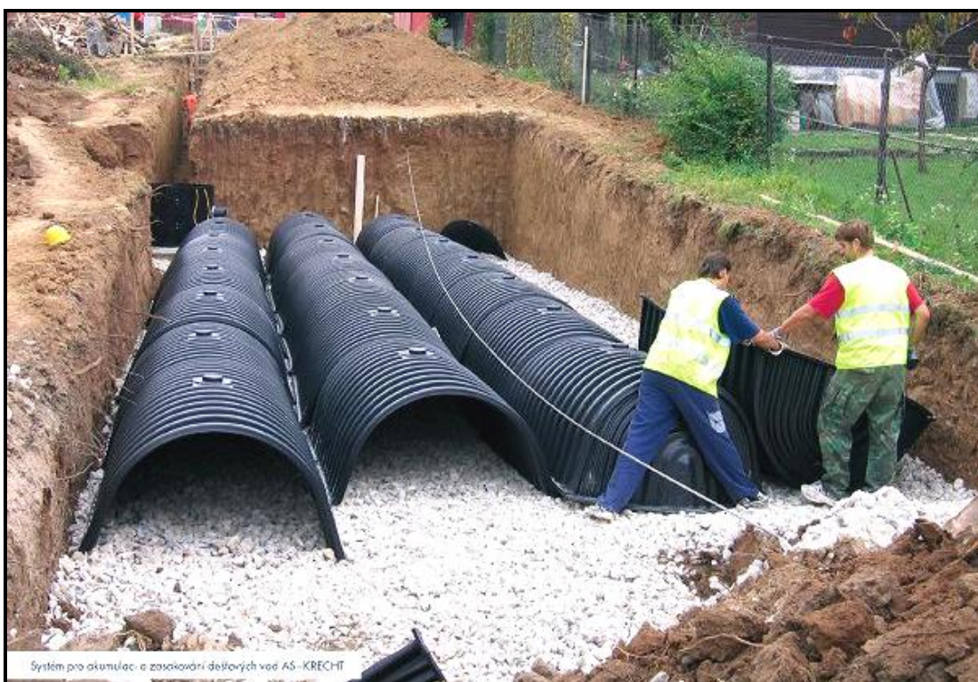
foto č. 6 Systém pro akumulaci a zasakování dešťových vod pomocí tunelového systému
