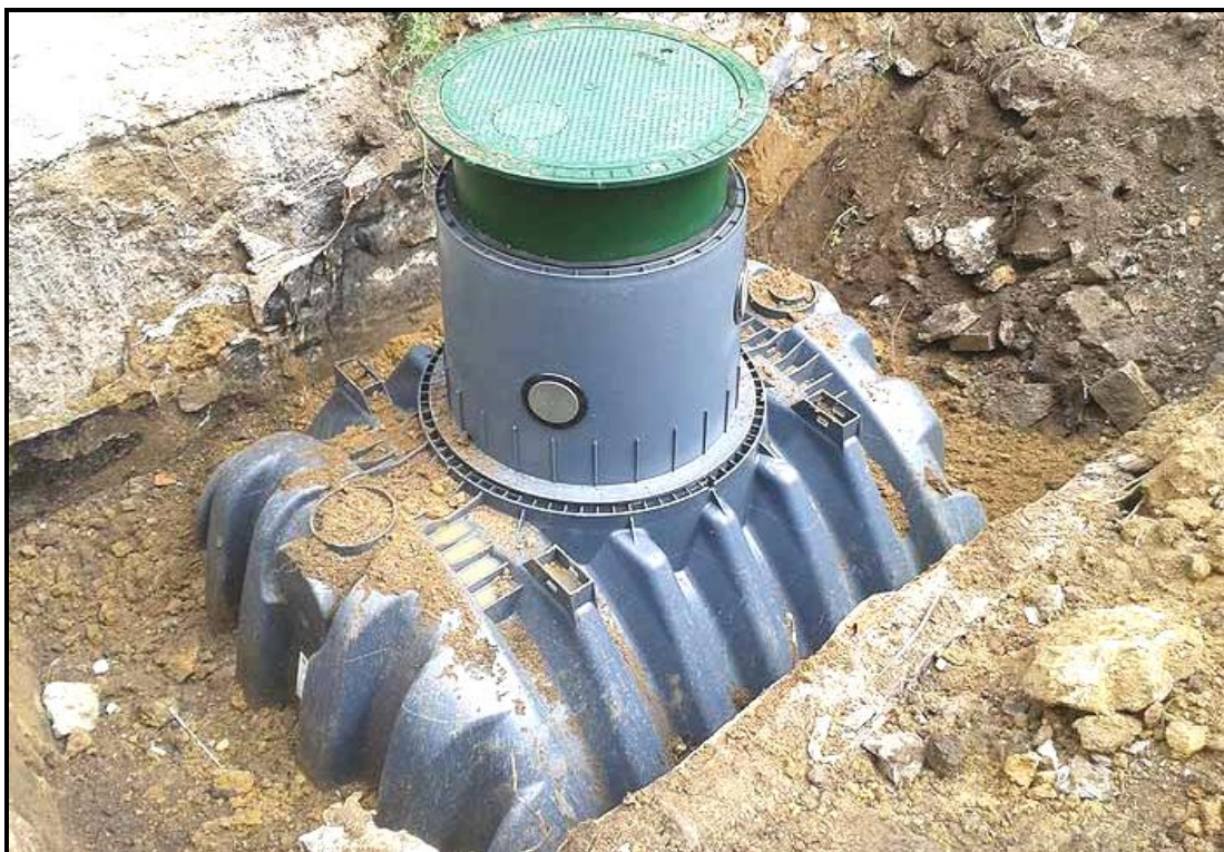
foto č. 19 Příklad akumulční nádrže
