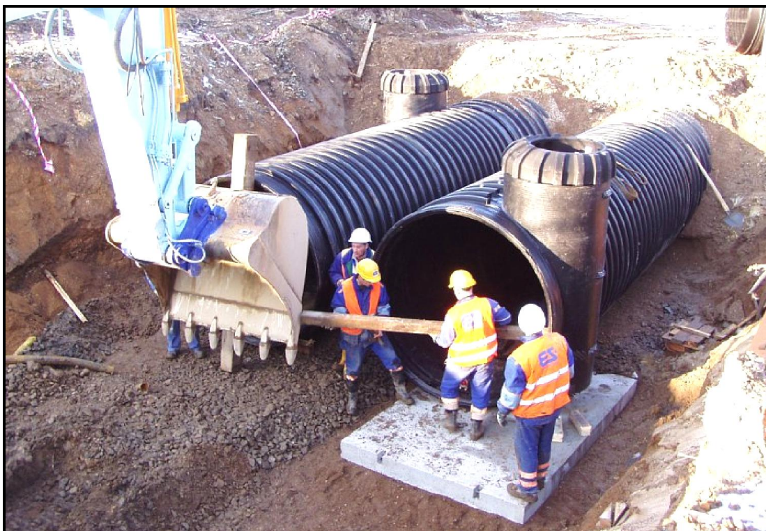
foto č. 20 Příklad akumulční nádrže
