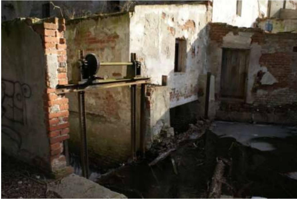
Obrázek 4 Strojovna turbíny Dubského mlýna s jalovou propustí
