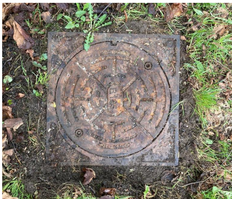
Obrázek 4.8 Kanalizační přípojka (vlastní foto)
