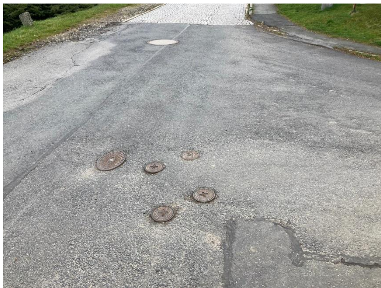
Obrázek 4.6 Revizní šachty kanalizace a povrchové znaky vodovodu (vlastní foto)
