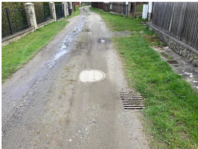
Obrázek 4.7 Stav kanalizace na nezpevněných komunikacích (vlastní foto)
