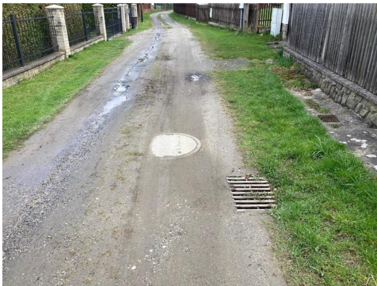
Obrázek 4.7 Stav kanalizace na nezpevněných komunikacích (vlastní foto)
