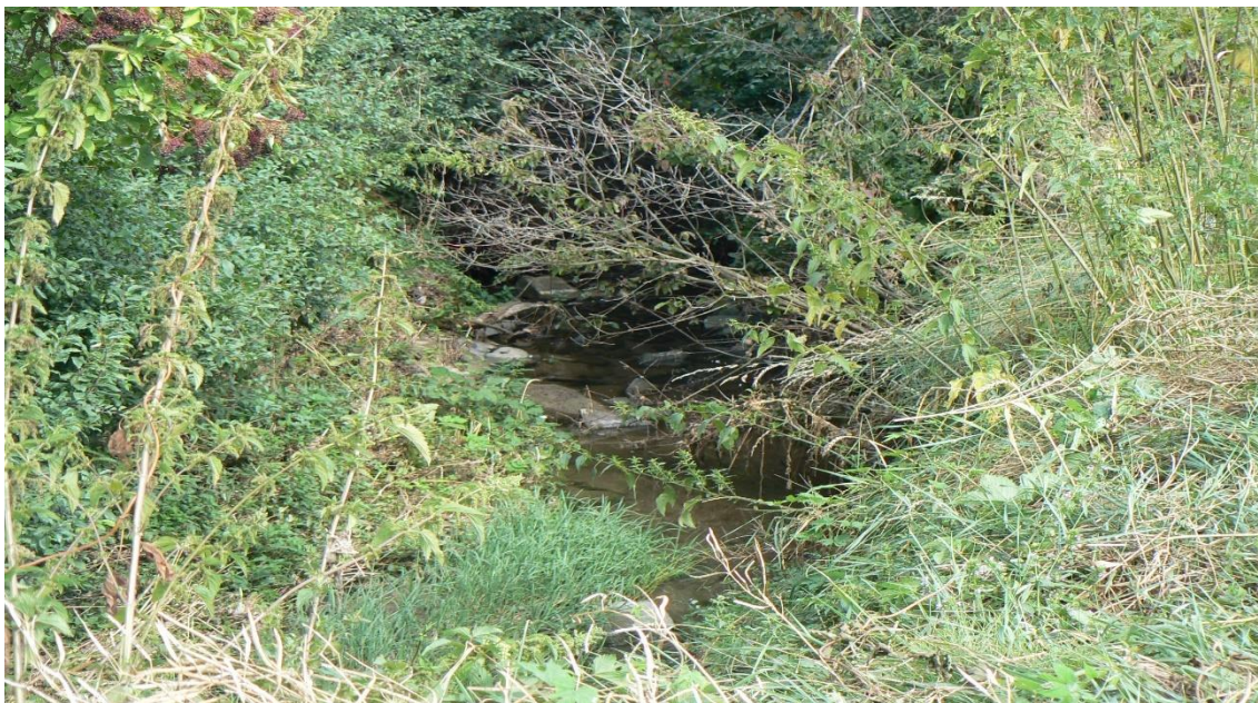
4.1-14 Zbytky betonového opevnění kynety za ČOV [7]
