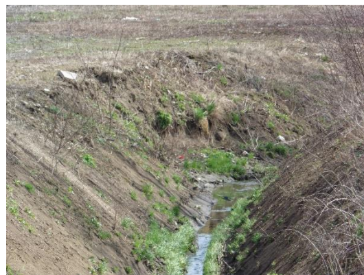
4.1-16 Poškození konkávního břehu [7]
