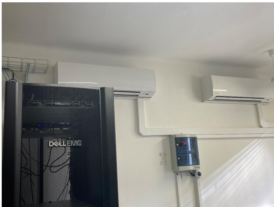
obrázek č. 25 – Klimatizační jednotky v serverovně, zdroj: vlastní zpracování
