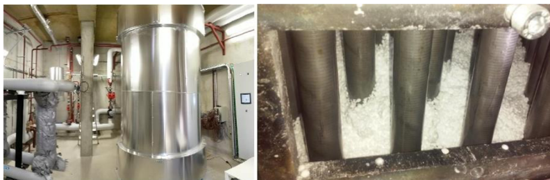
Obrázek 23 PCM zásobník tepla v Grenoble, Francie. Vnější pohled na nádrž s PCM (vpravo) a vnitřní pohled na volně ložené PCM s trubkami výměníku tepla [29]
