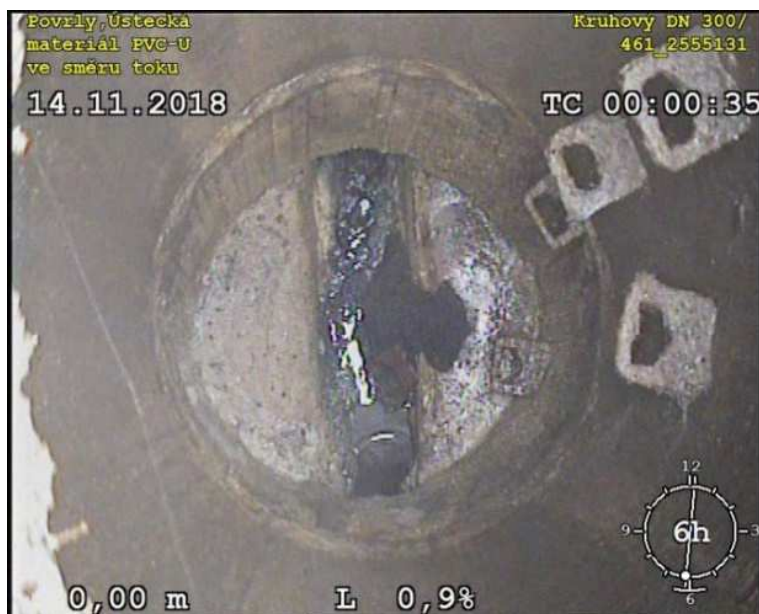
Obr. 18 - Nálitek asfaltu v kanalizační šachtě (vlastní foto)
