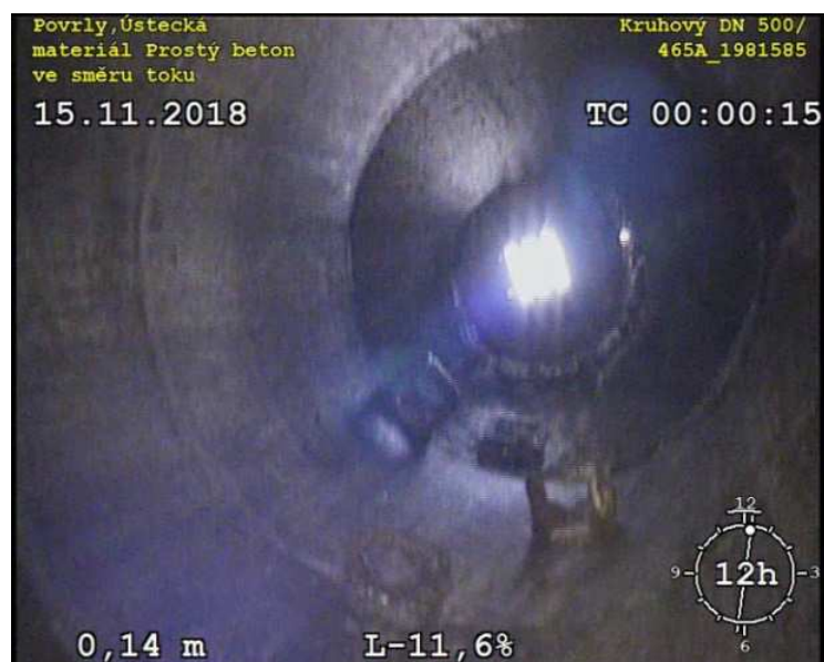
Obr. 27 - Koroze stupadel v šachtě
