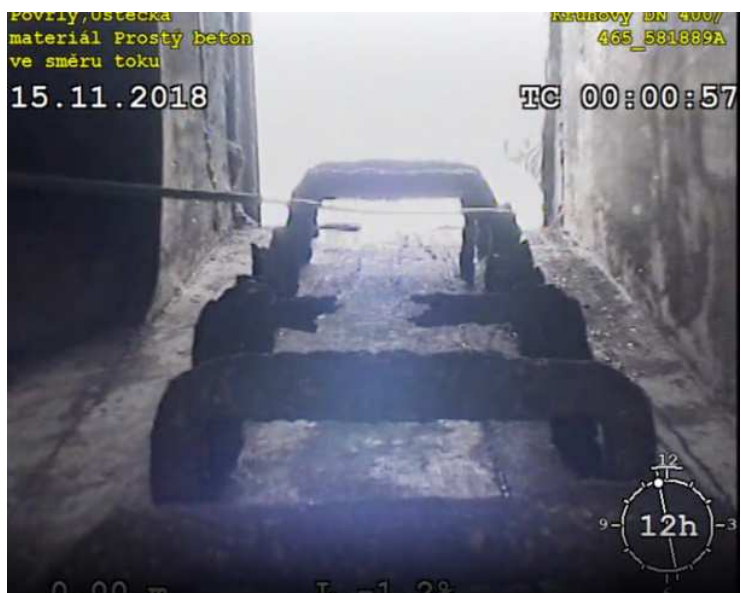
Obr. 25 - Poškozená stupadla v šachtě
