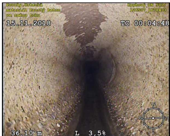
Obr. 32 - Koroze do 50% tloušťky stěny
