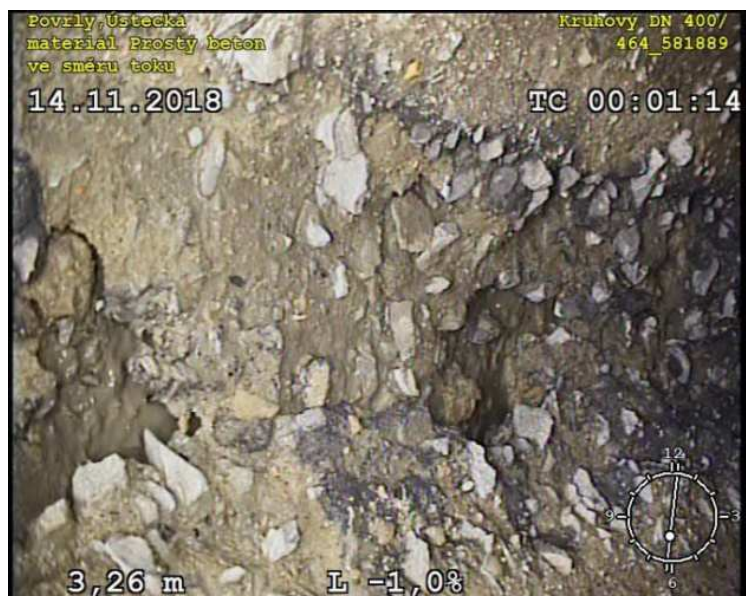
Obr. 24 - Kaverny ve dně potrubí
