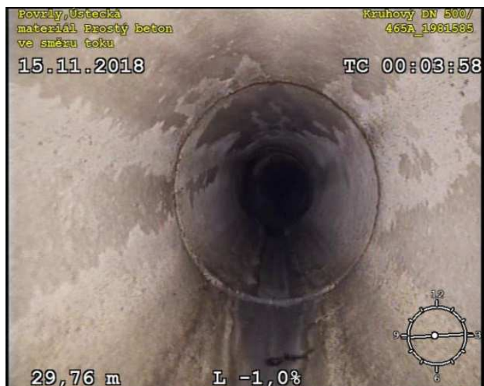
Obr. 28 - Mírná koroze do 50%
