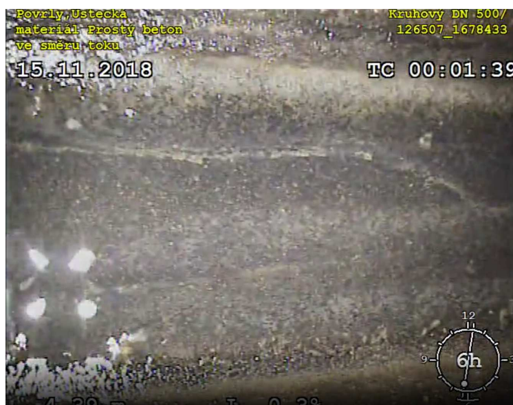
Obr. 31 - Prasklina v podélném směru trouby
