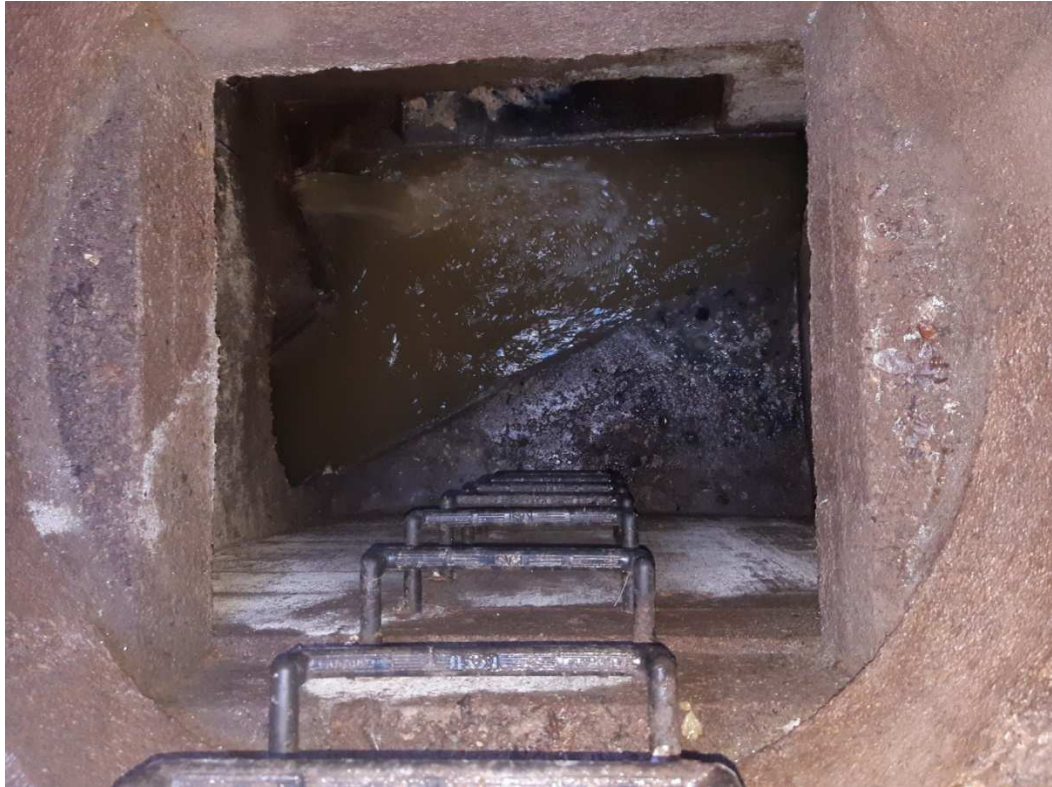
Obr. 39 - OK se zaústěným výtlakem z ČSOV Povrly
