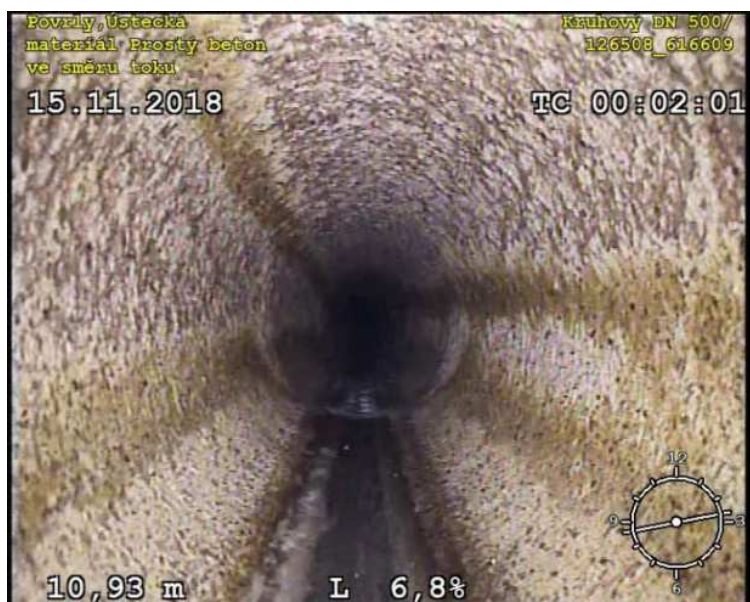
Obr. 29 - Koroze do 50% tloušťky stěny
