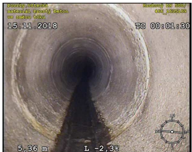
Obr. 35 - Mírná koroze stěny trouby do 50%
