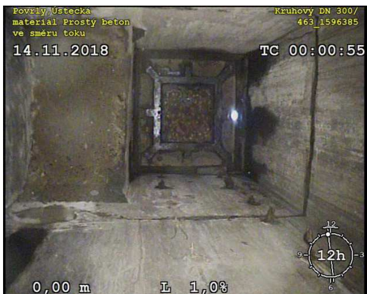
Obr. 21 - Chybějící stupadla v šachtě ID 463
