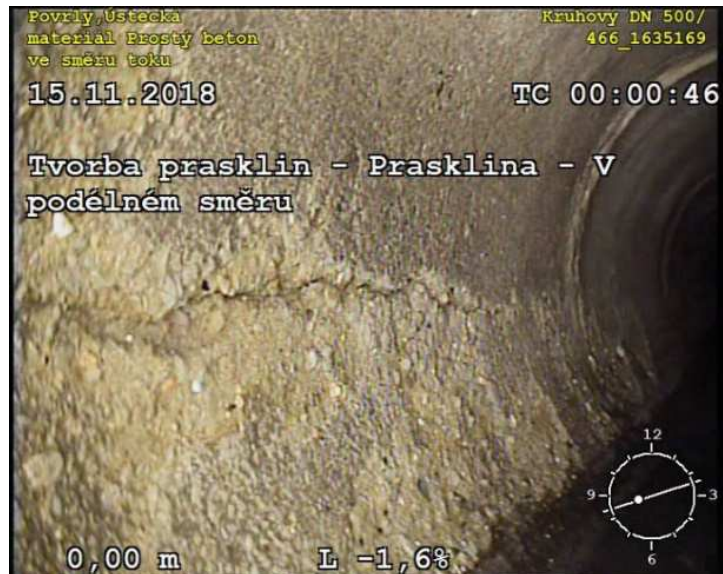
Obr. 36 - Prasklina v podélném směru
