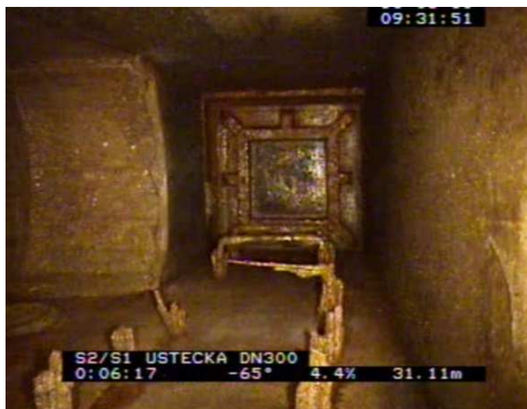
Obr. 16 - Zkorodovaná stupadla v kanalizační šachtě
