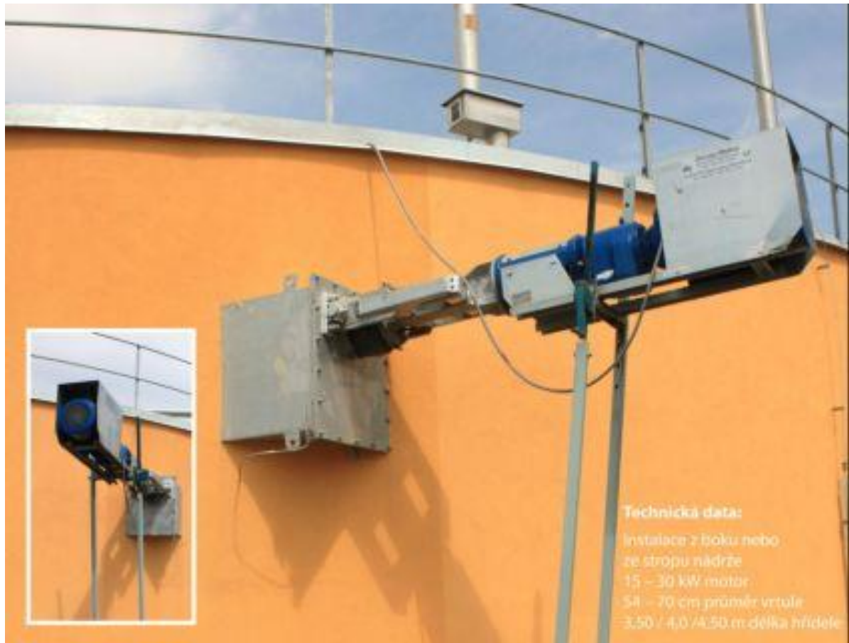
Obr. 8 Boční vrtulové míchadlo
