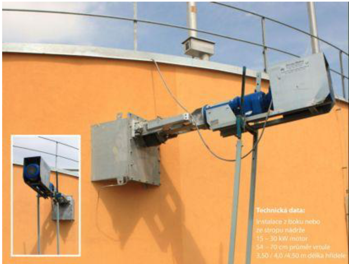
Obr. 8 Boční vrtulové míchadlo
