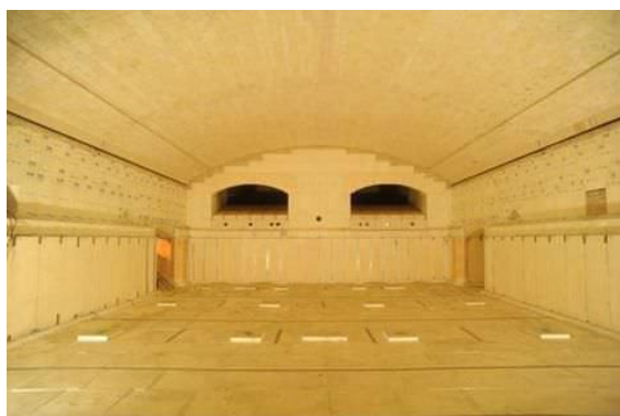
Obrázek 6: Sklářská pec - ukázka vyzdívky [26]
