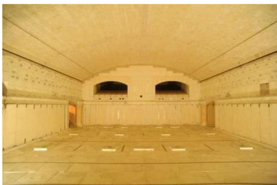
Obrázek 6: Sklářská pec - ukázka vyzdívky [26]
