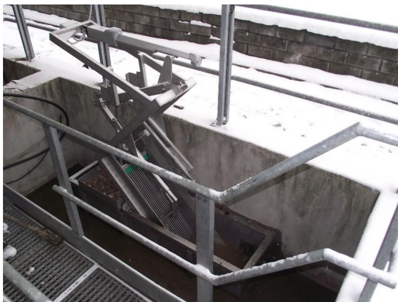
Obr. 3 Česle strojně stírané [57]
