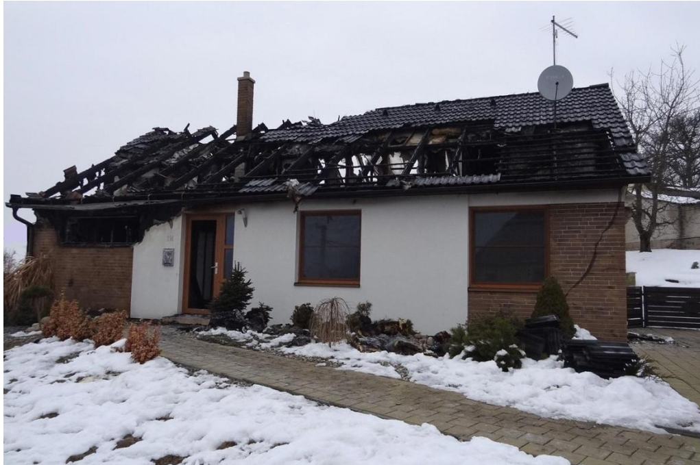
Obr. č. 9 – Stav rodinného domu po požáru, pohled jihovýchodní 123
