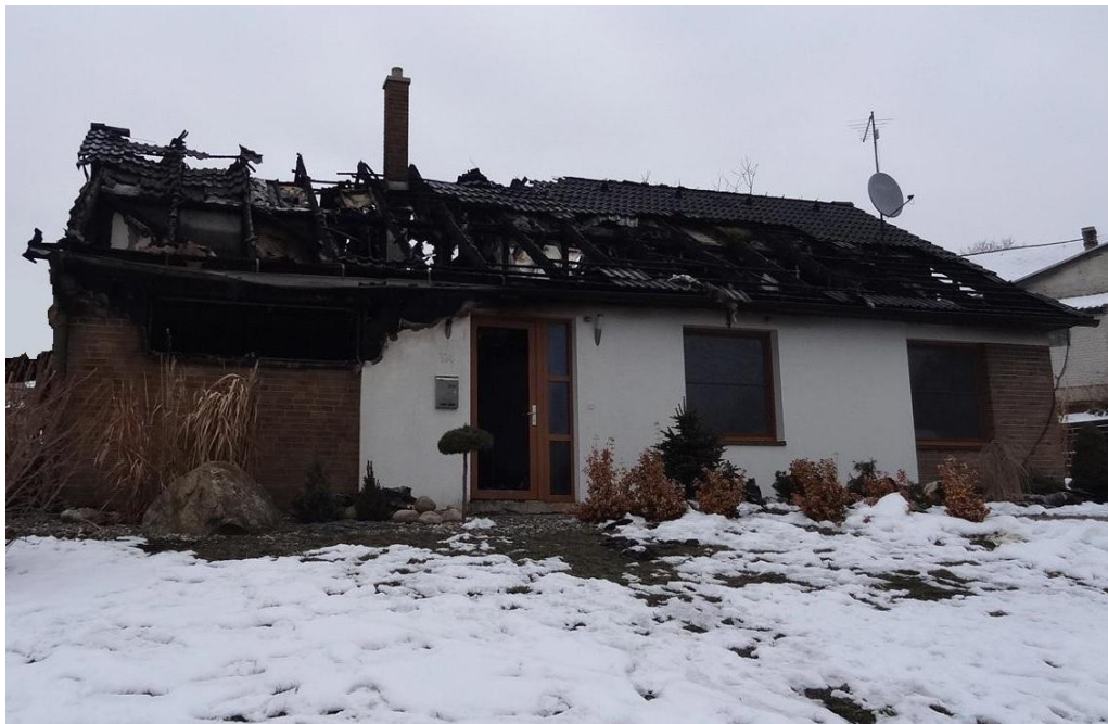
Obr. č. 10 – Stav rodinného domu po požáru, pohled jižní 124
