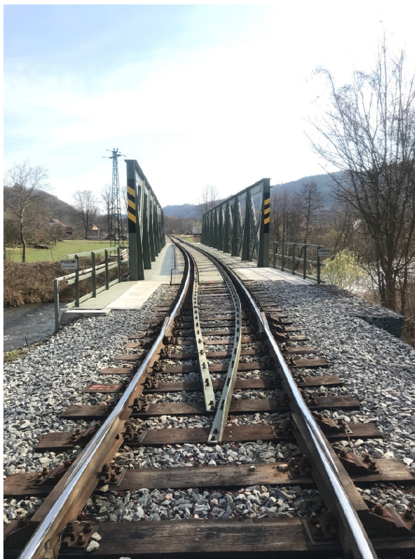
Kolejové dilatační zařízení na straně ložiska
