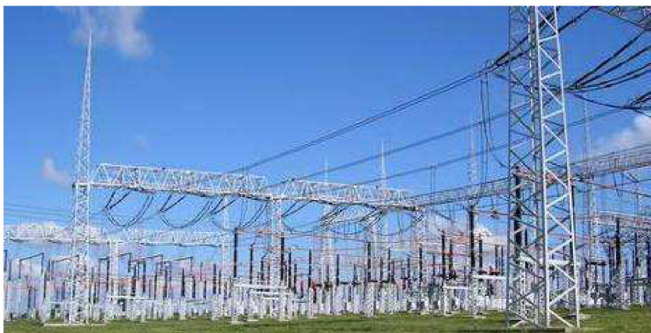
Obr. 5-2 Rozvodna ve Slavětích
