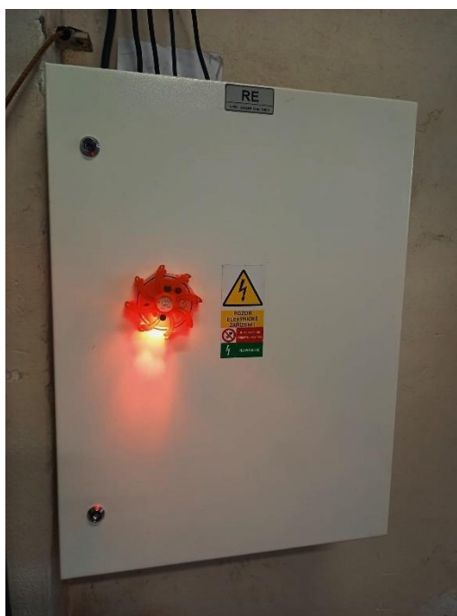
Obrázek 17: Označení nebezpečí úrazu elektrickým proudem. Zdroj: vlastní zpracování
