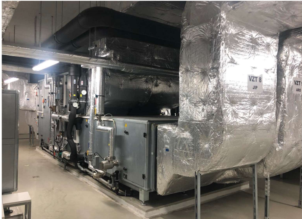
Obr. 15.2 – Měřená vzduchotechnická jednotka [22]
