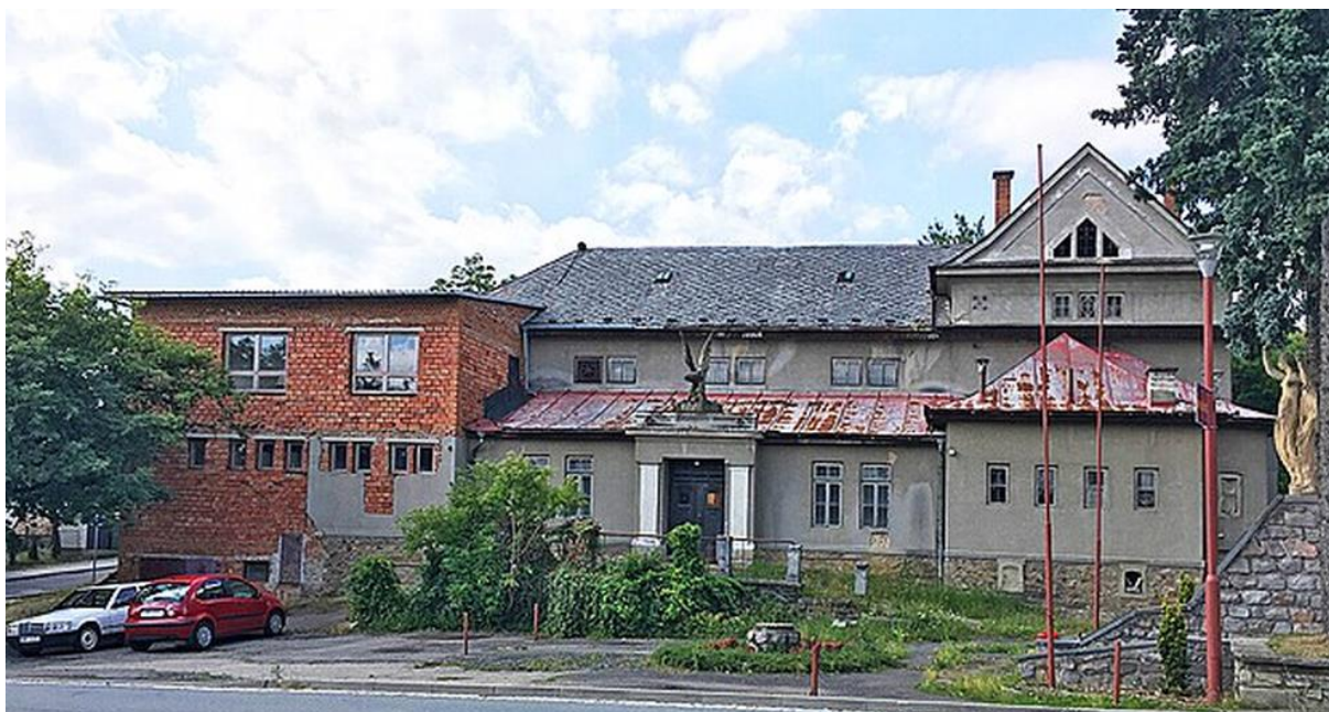
Fotografie 2: Budova konické sokolovny před zahájením rekonstrukce v roce 2017
