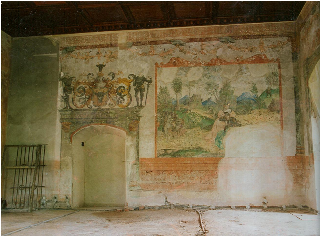
12. Vojtěchův sál – východní stěny, stav před restaurováním, 1993.
