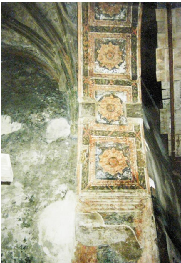
16. Vojtěchův sál – lící strana oblouku arkýře po sundání přelepů, před restaurováním, 1993.
