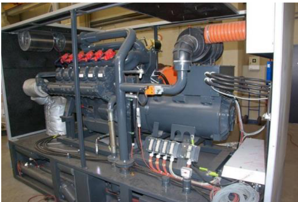
Obr. 3.2 Kogenerační jednotka s pístovým spalovacím motorem [27].
