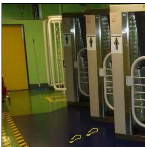
Obr. 10 – Portálové monitory PCM–2 pro kontrolu kontaminace osob před CDRK – na podlaze je nášlapná dekontaminační zóna (ČEZ, a. s., 2014a)
