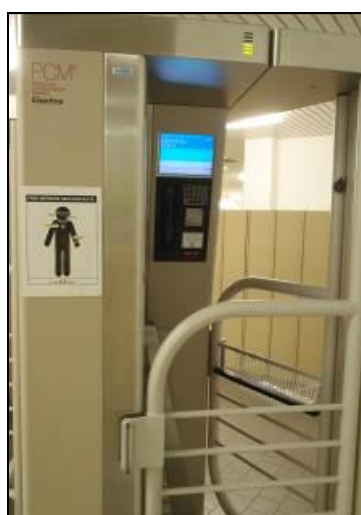
Obr. 11 – Portálové monitory PCM–2 pro kontrolu kontaminace osob na výstupu z nečisté šatny – na hranici kontrolovaného pásma (ČEZ, a. s., 2014a)
