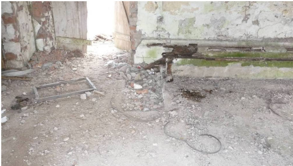
Foto č. 11 SO-01 - Krmný žlab, ocelové konstrukce zkorodované
