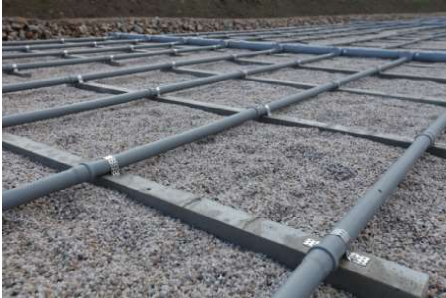
Obr. 30 Rozvody potrubí na vertikálním filtru (Michal Kriška-Dunajský)
