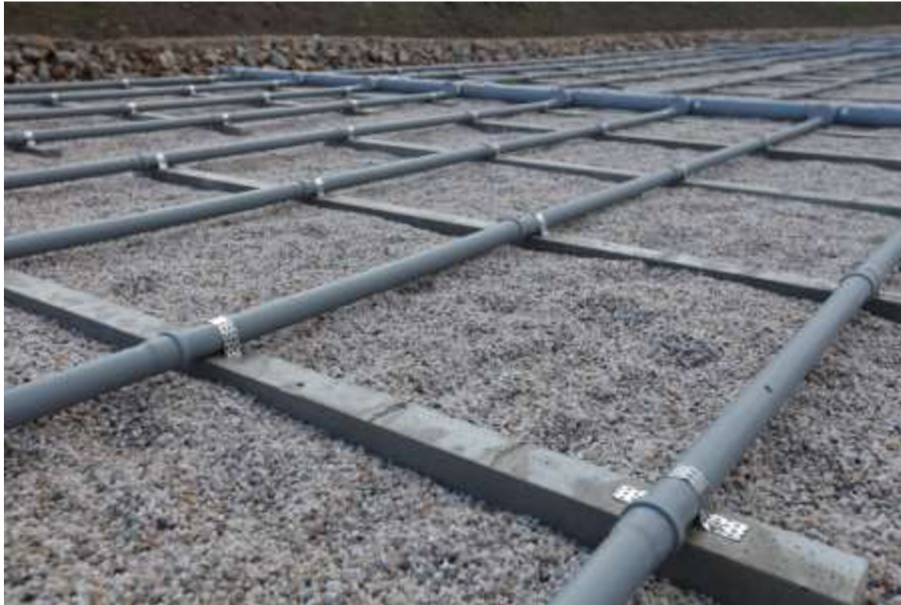
Obr. 30 Rozvody potrubí na vertikálním filtru (Michal Kriška-Dunajský)
