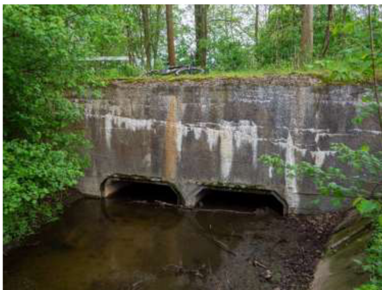
Obr. 19 Mimoúrovňové křížení Opatovického kanálu s potokem Bukovka (Martin Kanta)
