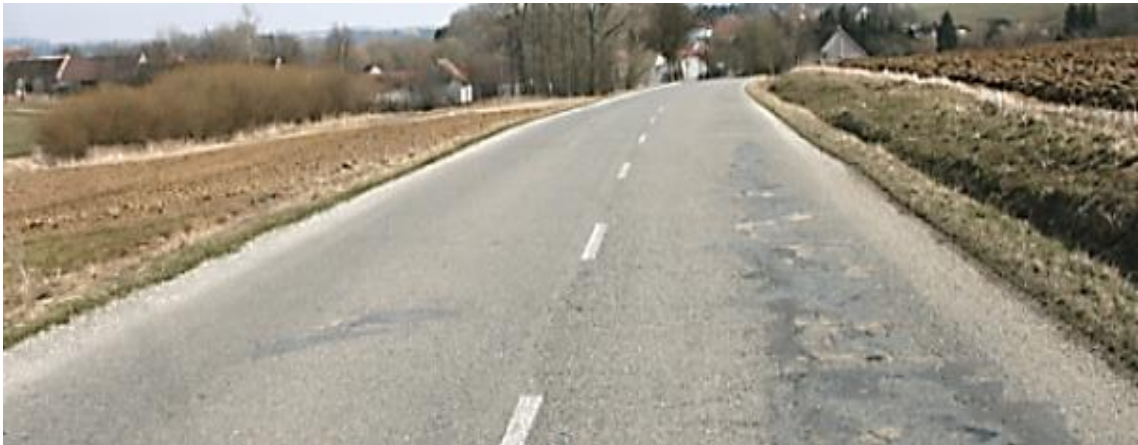
Obrázek 20 - Ukázka nevyhovujícího stavu komunikace [10]
