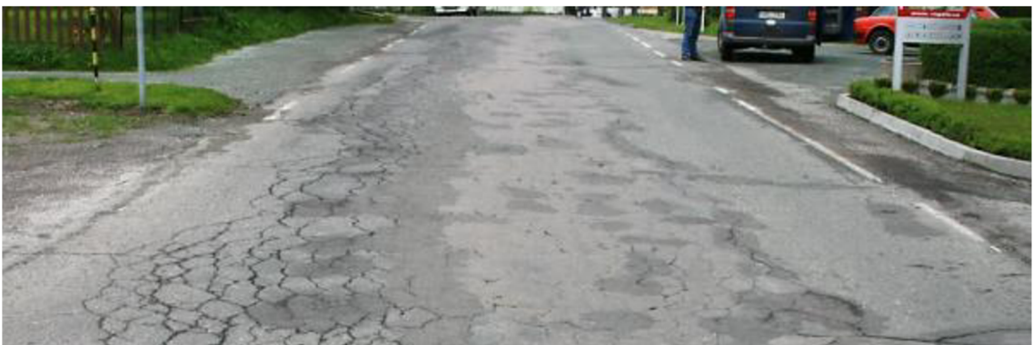
Obrázek 21 - Ukázka havarijního stavu komunikace [10]
