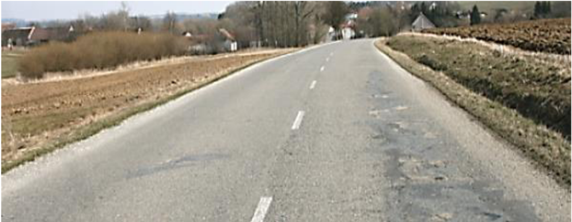
Obrázek 20 - Ukázka nevyhovujícího stavu komunikace [10]
