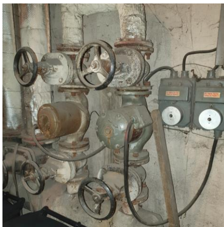
Obrázok 9.2 Obehové čerpadlá vykurovacej vody
