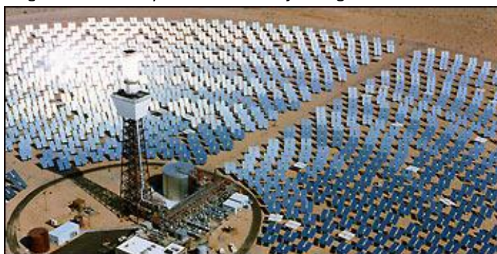
Obrázok 5.2 Solárna vežová elektrárňa [19]
