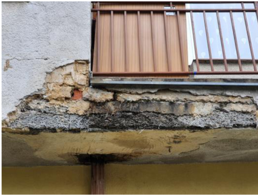
Obrázok 8.1 Zlý stav zvislých nosných konštrukcií a konštrukcie lodžie
