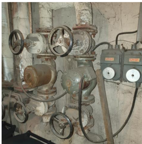
Obrázok 9.2 Obehové čerpadlá vykurovacej vody
