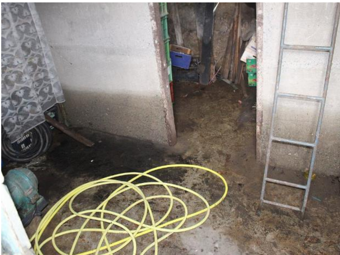
Obrázek 3-8 - Poškozený sklep povodní/záplavou [27]
