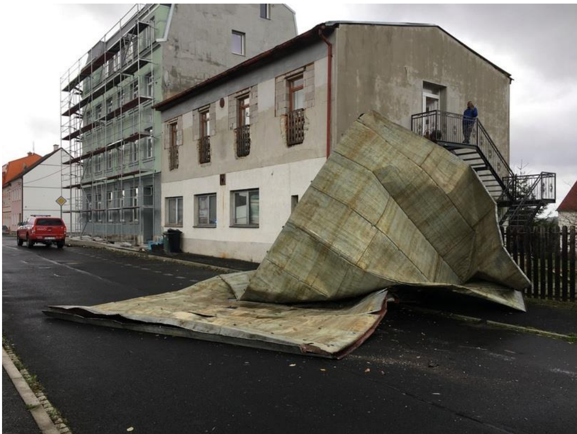
Obrázek 3-5 - Poškozená krytina vichřicí [24]
