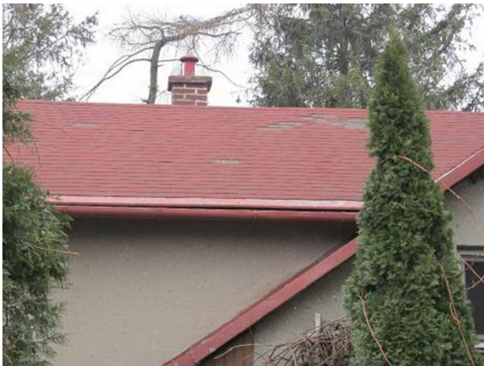
Obrázek 5-2 - Poškozená střešní krytina rodinného domu [interní materiál ČP]
