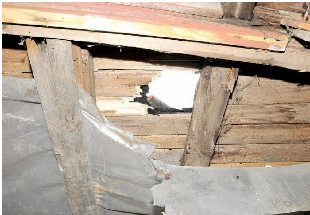
Obrázek 3-3 - Poškození střechy po přímém úderu blesku [29]
