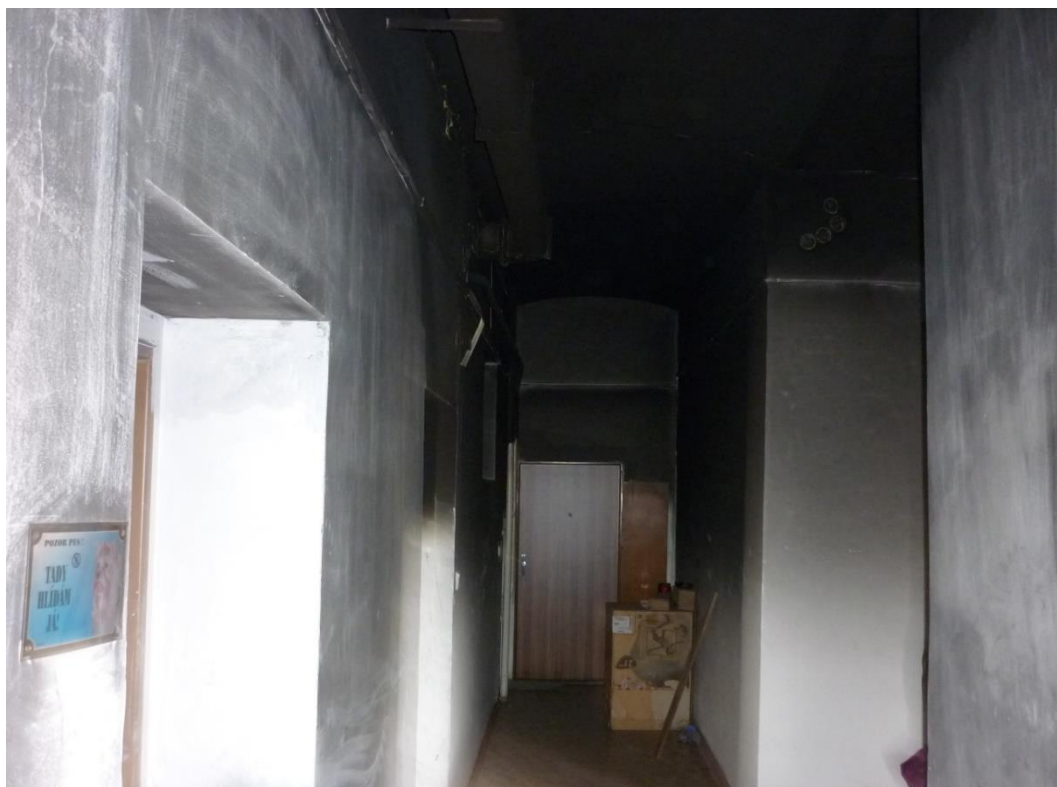
Obrázek 3-1 - Poškození nemovitosti požárem [21]
