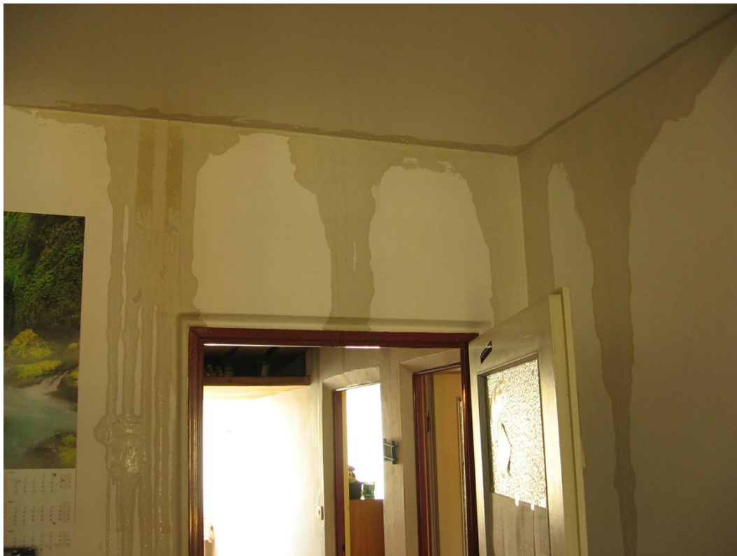
Obrázek 3-7 - Poškození výmalby vodou vytékající z vodovodního zařízení [26]
