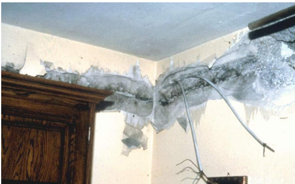
Obrázek 3-4 - Poškození elektroinstalace po přímém úderu blesku [28]
