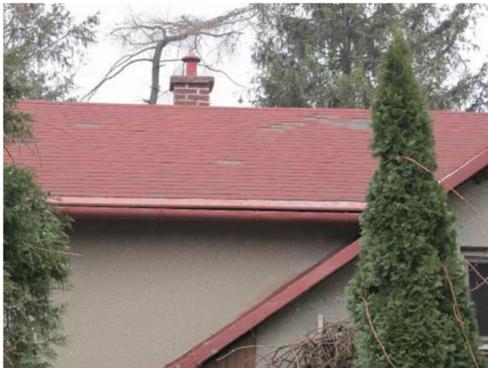
Obrázek 5-2 - Poškozená střešní krytina rodinného domu [interní materiál ČPJ]
