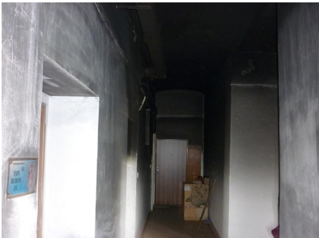
Obrázek 3-1 - Poškození nemovitosti požárem [21]
