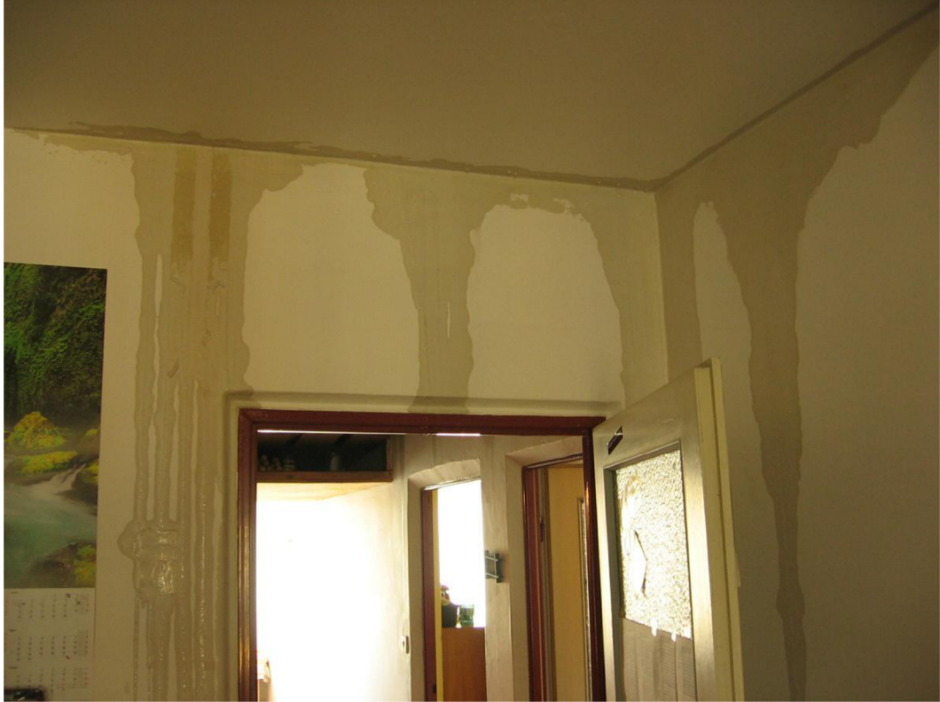
Obrázek 3-7 - Poškození výmalby vodou vytékající z vodovodního zařízení [26]
