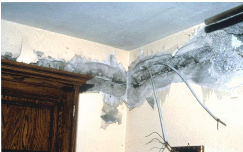
Obrázek 3-4 - Poškození elektroinstalace po přímém úderu blesku [28]
