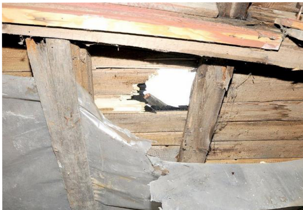
Obrázek 3-3 - Poškození střechy po přímém úderu blesku [29]
