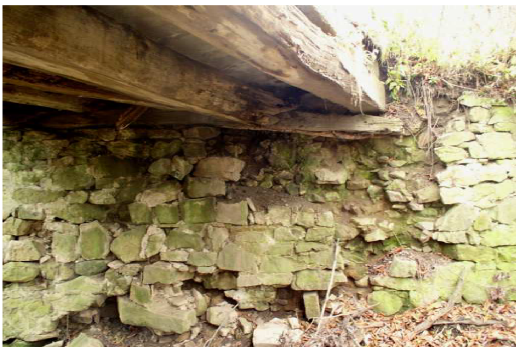
Obr. 4-8 Konstrukce silničního mostu, pohled na deformaci opěrné zdi
