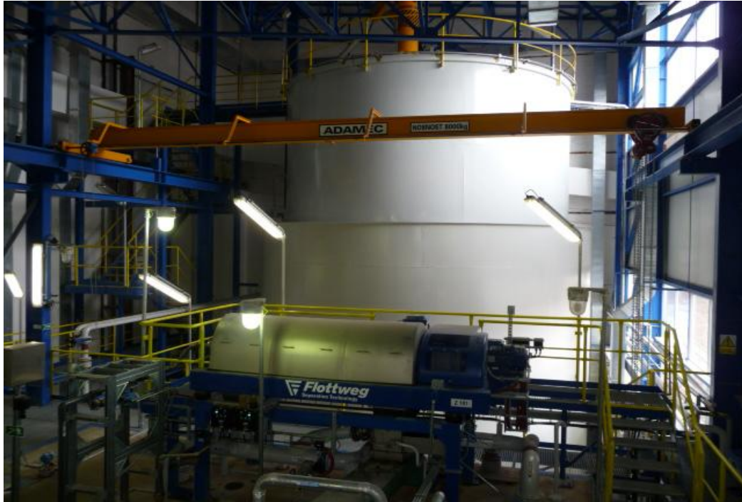
Obrázek 8 – Dekantační odstředivka Z 101, homogenizační nádrž H 101 s míchadlem na T 700 Unipetrol RPA s.r.o.
