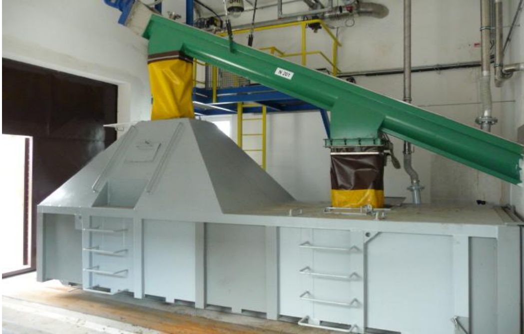
Obrázek 6 – Šnekový dopravník N 201, kontejner H 206 pro uskladnění odvodněných flotačních kalů na BČ III Unipetrol RPA s.r.o.
