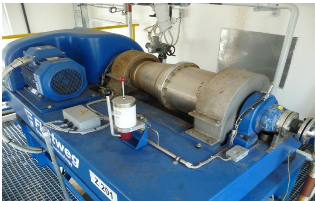
Obrázek 5 – Dekantační odstředivka Z 201 k odvodnění plovoucích flotačních kalů na BČ III Unipetrol RPA s.r.o.
