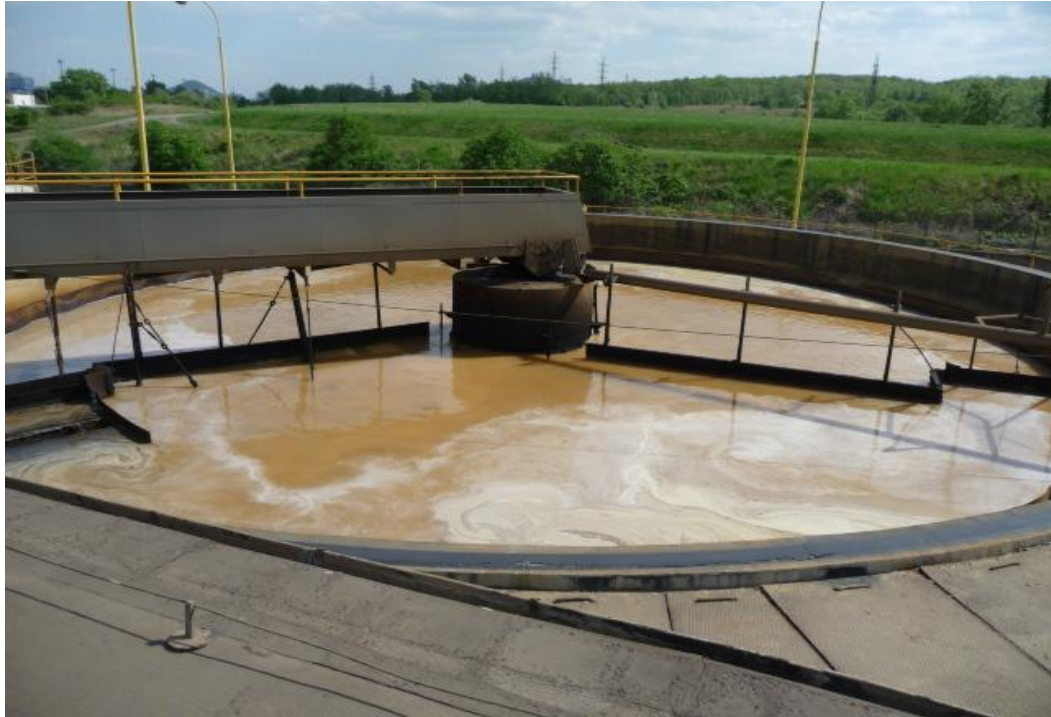
Obrázek 4 – Flotační nádrž AM 112 na BČ III Unipetrol RPA s.r.o.
