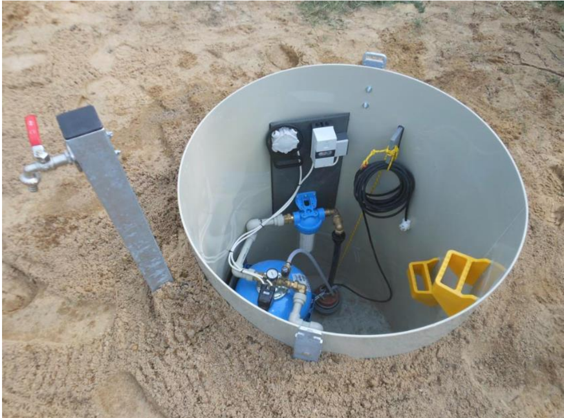
Obrázek 15 – Zhlaví studny (Vrty Tenenko, 2023)
