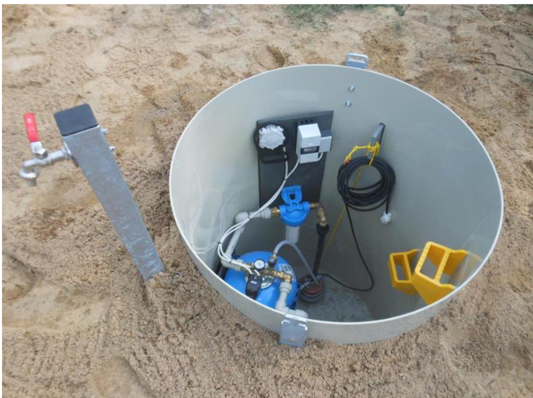
Obrázek 15 – Zhlaví studny (Vrty Tenenko, 2023)
