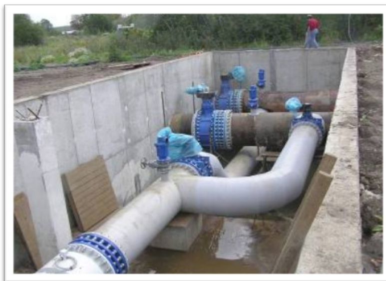
Foto č. 1: Rozdělovací šachta přivaděče z PVN
