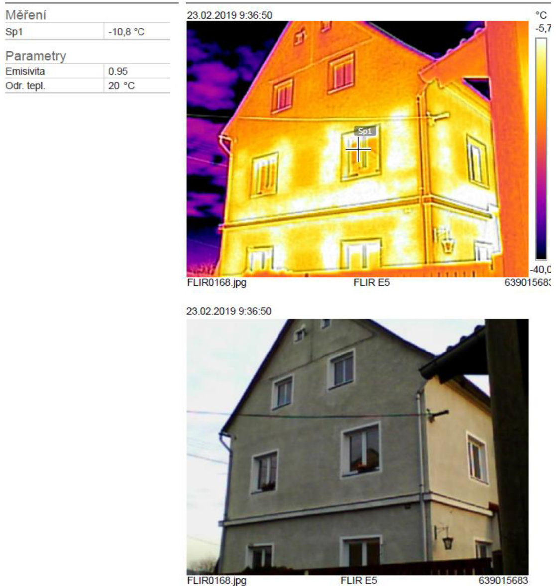
Obrázek 26 Termovizní měření budovy bez zateplení (Zdroj: vlastní)
