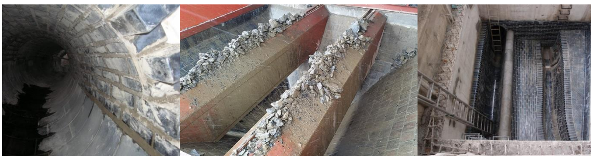
Obrázek 3: Vlevo - cihelná klenba a obklad stoky DN800; uprostřed - násypka na kámen; vpravo - odlehčovací komora [4]
