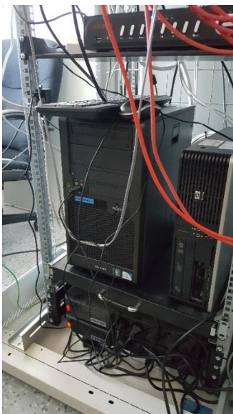
Obrázek č. 4 – Server Tower
